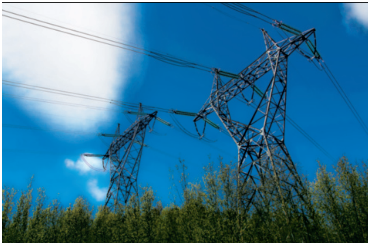
Figur 5.1 420 kV-ledning ved Stols vassdammen i Hol i Hallingdal
