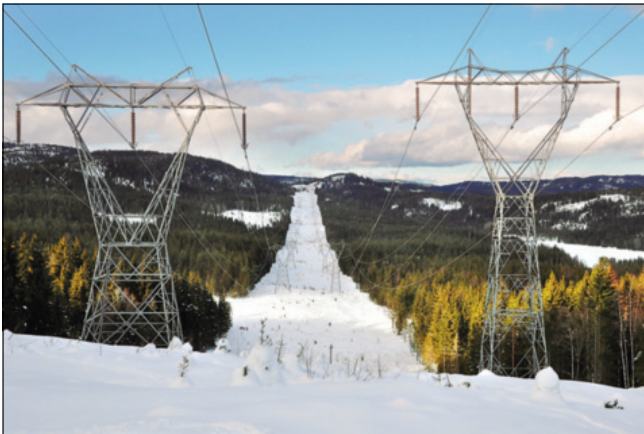
Figur 6.2 300 kV-ledning ved Ullevålseter, Oslo
